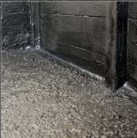
Auch dicht in den Ecken
