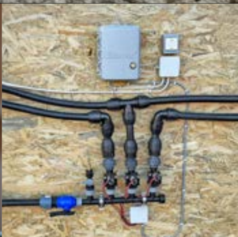
Verteiler mit Magnetventilen
