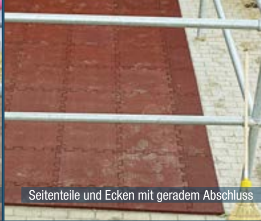
Einfach auf die Pflasterseine gelegt
